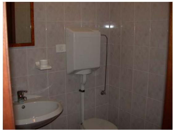
...altro bagno con lavabo e wc
